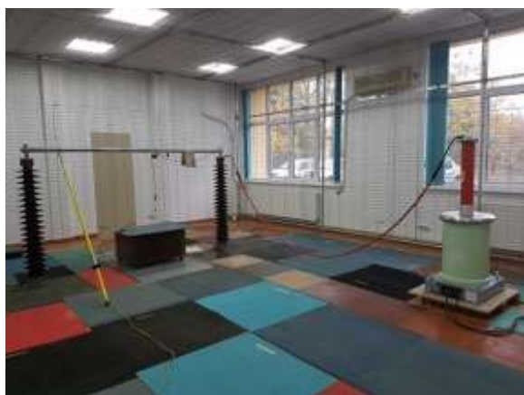
Fig.9 Standul de încercări cu tensiune mărită
