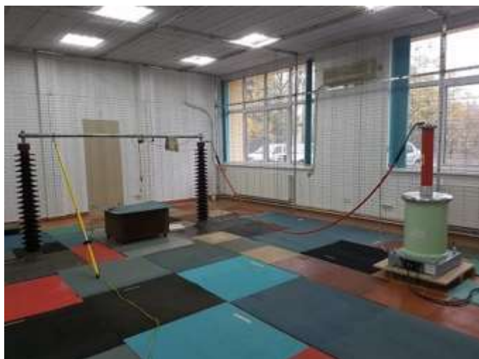
Fig.16 Standul de încercări cu tensiune mărită
