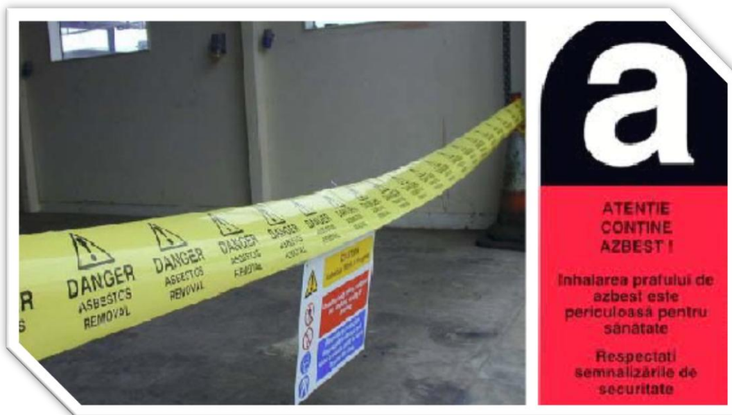
Fig.28. Utilizarea avertismentelor (indicând „Pericol depunere de azbest”) și semnalizarea pentru delimitarea unei zone 81 .
