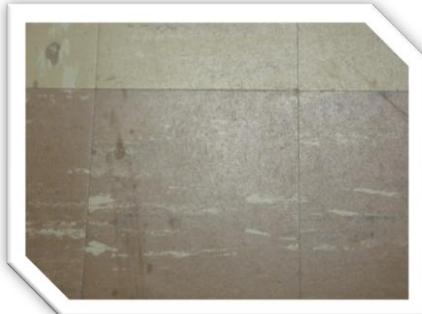
Fig.12. Dale de pardoseală vinil-azbest 26
